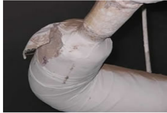
Torn asbestos pipe lagging
